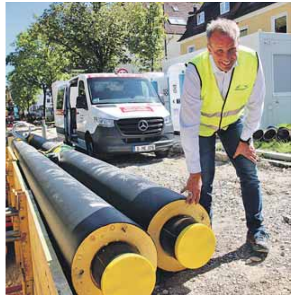
Thomas Winkler erklärt das Verfahren an den Spezialrohren. Foto: Tilmann Seiffert ( http://tilmseiffert.de )
