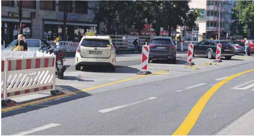
Die gelben Klebestreifen, die in der Fürstenrieder Straße die aktuell gültige Fahrbahn durch die Baustelle markieren sollen, haften nicht überall gut. Foto: kö
