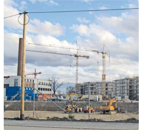
Großbaustelle: Im Diamaltgelände soll der Straßenausbau noch im Frühjahr beginnen. Der genaue Zeitplan hängt vom Fortschritt der Hochbauarbeiten ab. Bild: sb
