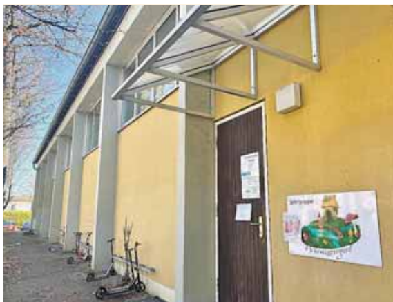
Auch die Krailling Turnhalle wartet auf Sanierung. Hier muss mindestens das Dach neu gedeckt werden. Foto: Ulrike Seiffert
