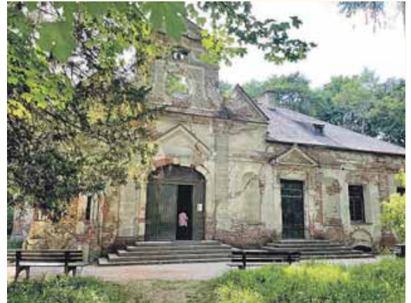
Die Magdalenenklause wurde als Ruine geplant. Sie ist gemauert und nur teilweise verputzt. Die Risse im Mauerwerk und der abbröckelnde Putz sind Stilelemente. Foto: bb
