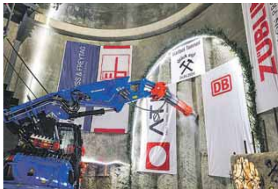
Das 55 m lange Rettungsbauwerk liegt in bis zu 34 Metern Tiefe an der Hackerbrücke. Foto: DB AG/panterra.tv
