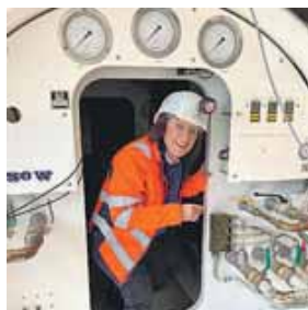
Bärbel Fuchs ist Patin für den Tunnel, der u.a. elf Gleise im Gleisvorfeld des Hauptbahnhofs unterquert.
