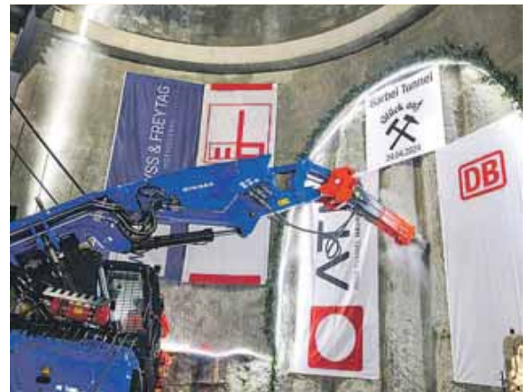
Das 55 m lange Rettungsbauwerk liegt in bis zu 34 Metern Tiefe an der Hackerbrücke. Foto: DB AG/panterra.tv
